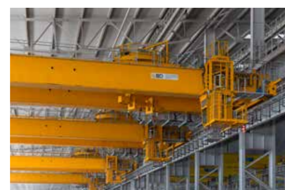
4 крана тяжелого режима работы с поворотным механизмом (заказчик ОАО «БМЗ» - управляющая компания холдинга «БМК»)
